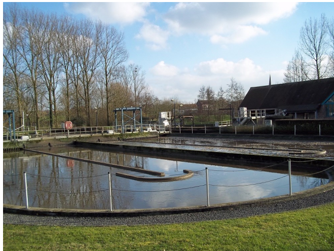
Station d'épuration d'Enghien
